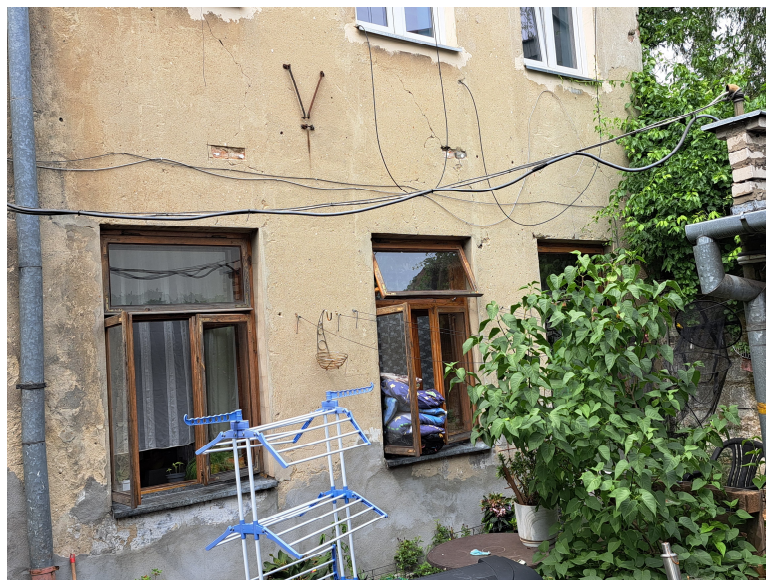
Zdjęcie nr 7: Widok uszkodzeń ściany zewnętrznej nad otworami okiennymi
