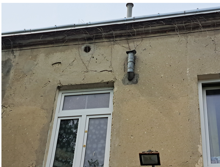
Zdjęcie nr 3: Widok uszkodzeń nadproża i tynku okna na kondygnacji piętra
