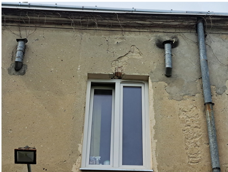
Zdjęcie nr 4: Widok uszkodzeń nadproża i tynku okna na kondygnacji piętra
