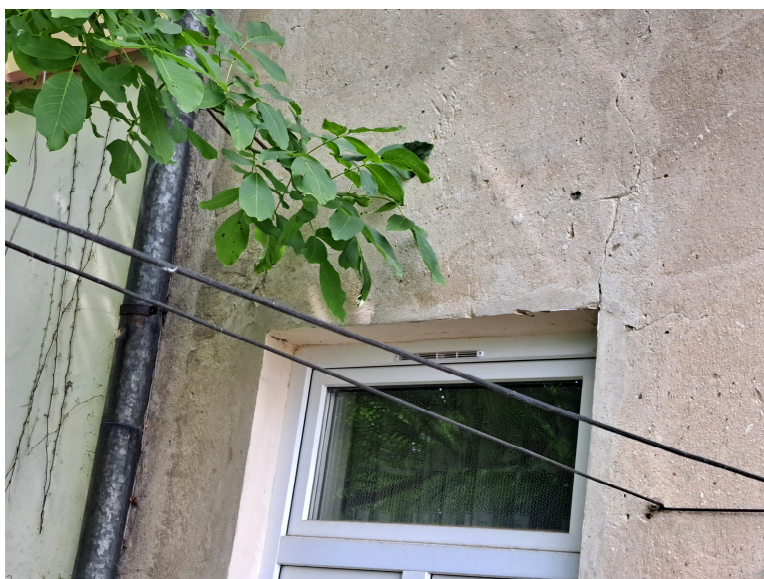
Zdjęcie nr 6: Widok uszkodzeń nadproża i tynku okna na kondygnacji parteru
