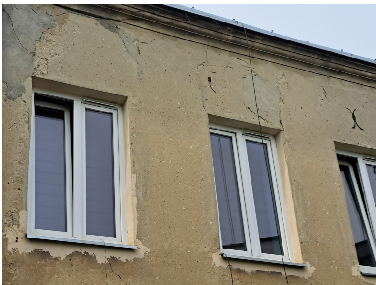
Zdjęcie nr 5: Widok uszkodzeń nadproża i tynku okna na kondygnacji piętra
