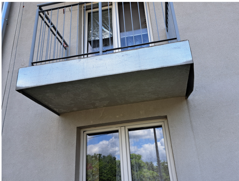
Zdjęcie nr 2: Widok dolnej powierzchni płyty balkonowej, widoczne wysolenia na powierzchni tynku, widoczna obróbka krawędziowa z blachy ocynkowanej (budynek 8A)
