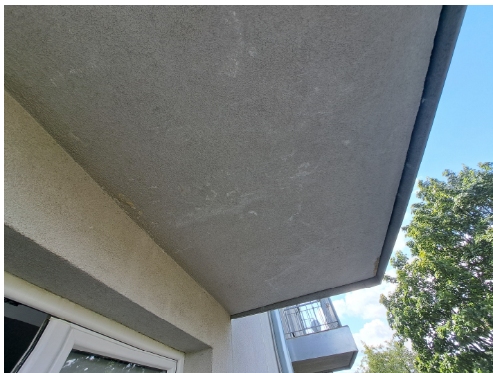
Zdjęcie nr 4: Widok dolnej powierzchni płyty balkonowej, widoczne wysolenia na powierzchni tynku, widoczna dolna część obróbki krawędziowej z blachy ocynkowanej (budynek 8A)
