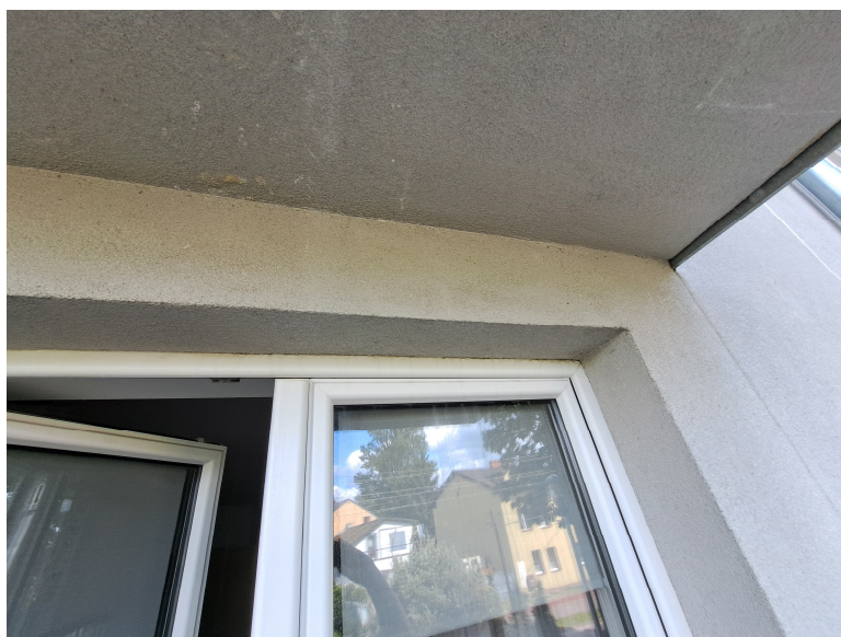
Zdjęcie nr 5: Widok dolnej powierzchni płyty balkonowej na połączeniu z nadprożem, widoczne zanieczyszczenia na profilach z PCV oraz szybach drzwi balkonowych (budynek 8A)
