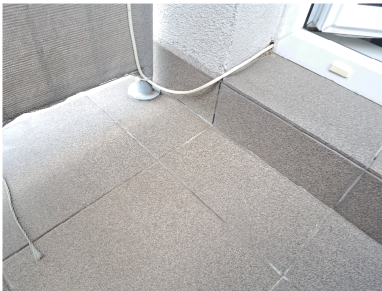
Zdjęcie nr 6: Widok posadzki balkonu z płytek gresowych, widoczne ubytki w spoinach między płytkami (budynek 8A)
