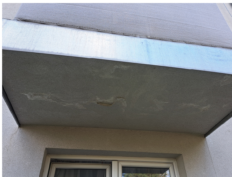
Zdjęcie nr 1: Widok dolnej powierzchni płyty balkonowej, widoczne odspojenia tynku cienkowarstwowego oraz wysolenia na powierzchni tynku, widoczna obróbka krawędziowa z blachy ocynkowanej (budynek 8A)
