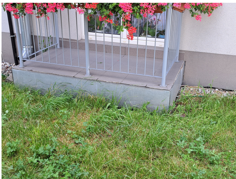
Zdjęcie nr 3: Widok górnej powierzchni płyty balkonowej na gruncie, widoczne uszkodzenia płytek gresowych oraz brak obróbki blacharskiej (kapinosy) na krawędzi płyty (budynek 8A)
