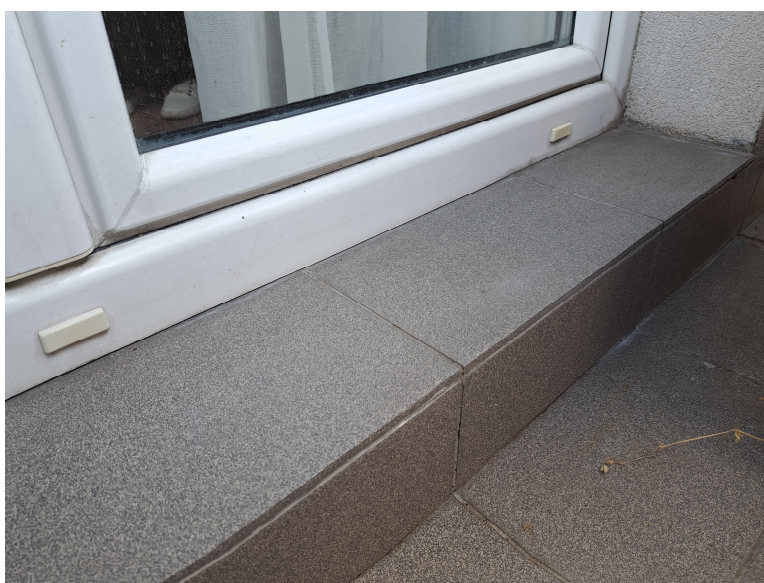
Zdjęcie nr 7: Widok posadzki balkonu z płytek gresowych, widoczne ubytki w spoinach między płytkami oraz nieszczelności na połączeniu profilu PCV drzwi balkonowych z okładziną progu (budynek 8A)
