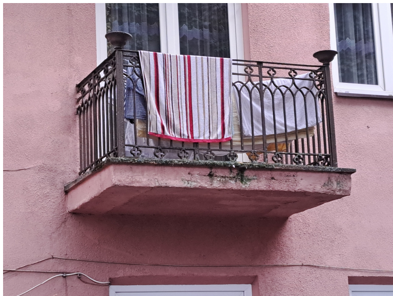
Zdjęcie nr 3: Widok balkonu 1-go piętra, widoczne nieznaczne uszkodzenia płyty balkonowej oraz zdegradowane krawędzie jastrychu cementowego
