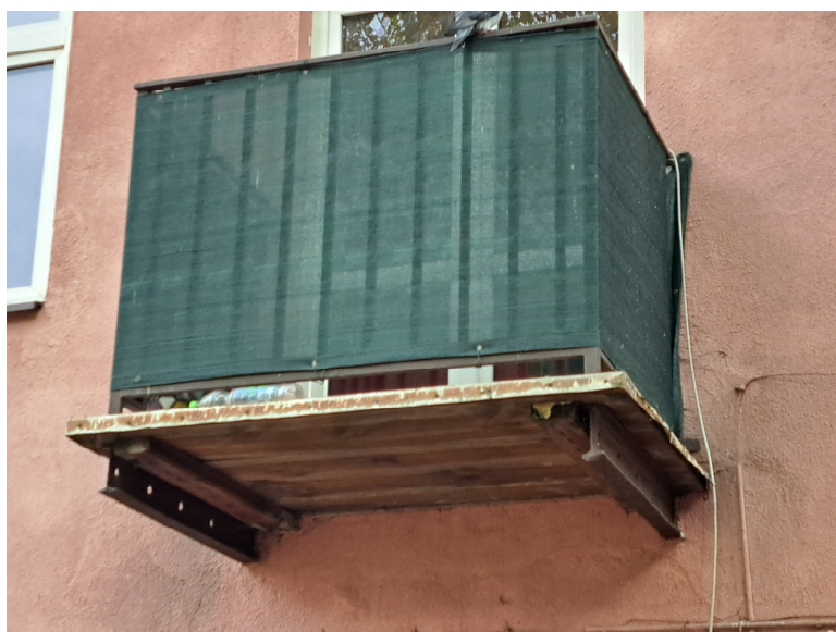
Zdjęcie nr 5: Widok balkonu 1-go piętra, widoczna korozja konstrukcyjnych elementów stalowych
