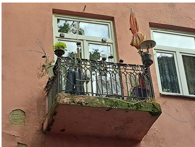
Zdjęcie nr 2: Widok balkonu 2-go piętra, widoczne uszkodzenia płyty balkonowej, ślady zawilgocenia i przemarzania oraz korozja konstrukcyjnych elementów stalowych
