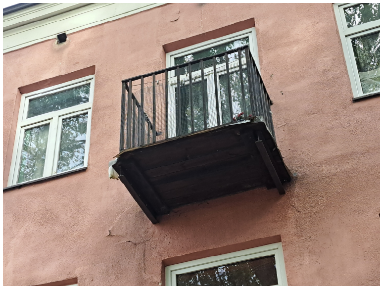
Zdjęcie nr 6: Widok balkonu 2-go piętra, widoczna korozja obróbek blacharskich płyty z desek drewnianych, widoczny brak osłonięcia i zabezpieczenia konstrukcyjnych belek stalowych
